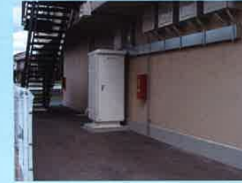
介護施設 様 蓄電池
